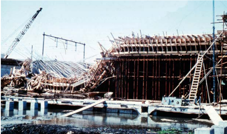
FIGUUR 1.3 Toelaatbare sterkte overschreden, bezwiken betonbekisting
