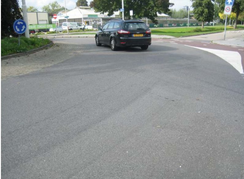
FIGUUR 1.4 Viskeuze vervorming in asfalt door verkeersbelasting
